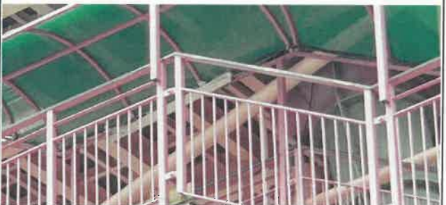
더블익스트림1 : 승강장 계단 내 조명전선 정리 보수요함.(7-3-1항)
