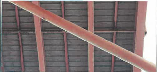
웨이브캐년 : 수로 내 슬라이드 탑승계단 부식부 낙하물 추락방지 조치요함.(11-1-1항)
