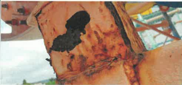
스프레쉬어드벤처 : 슬라이드 지지 구조부재 과다부식부 보수요함.(1-5-1항)
