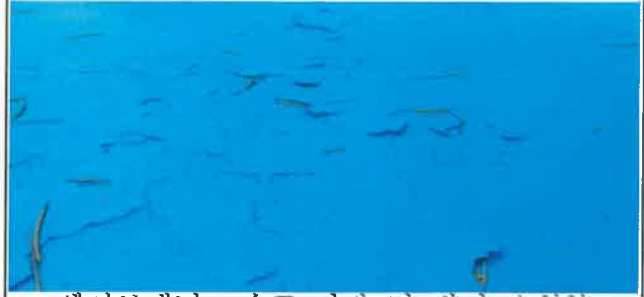
웨이브캐년 : 수로 바닥 및 벽면 요철부 보수요함.(9-3-9항)
